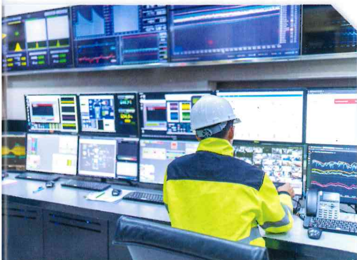
SCADA 的重要關鍵因素之一為操作人員，重要工業設施的控制系統，幾乎都有一個或多個操作人員，負責確保實體製程的安全運行。
